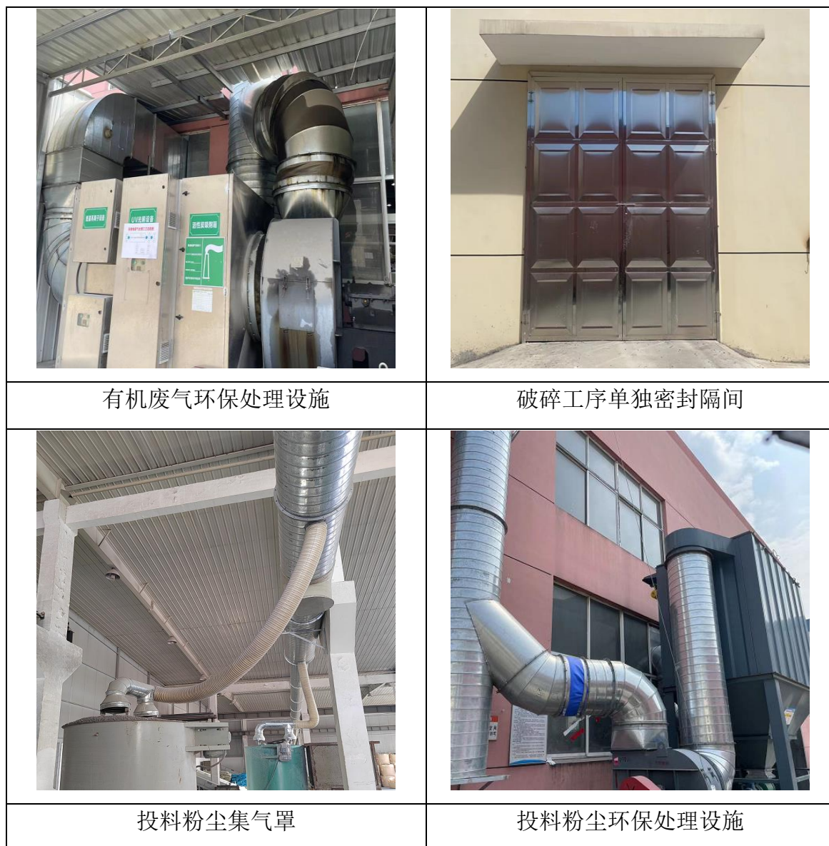
图4-4 项目废气处理设施相关照片
