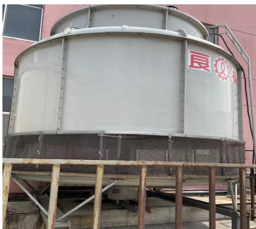
图4-1 项目冷却塔及冷却水池
